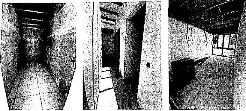
Maletero, cuarto de data, oficina y baños en edificio de recepción.
